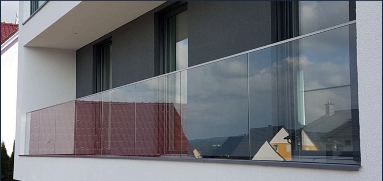
Ganzglasgeländer mit klarem Verbundsicherheitsglas (VSG)
